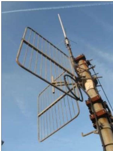
De 10dB Corner reflector opgesteld in Breskens
