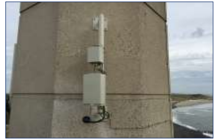
Voor small cells hoeven geen masten geplaatst te worden, men maakt gebruik van de ter plaatse aanwezige mogelijkheden
