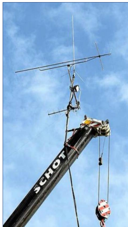
De antenne opstelling voor VHF en UHF gemonteerd op de drager constructie in de top van de kraan op 35 meter hoogte
